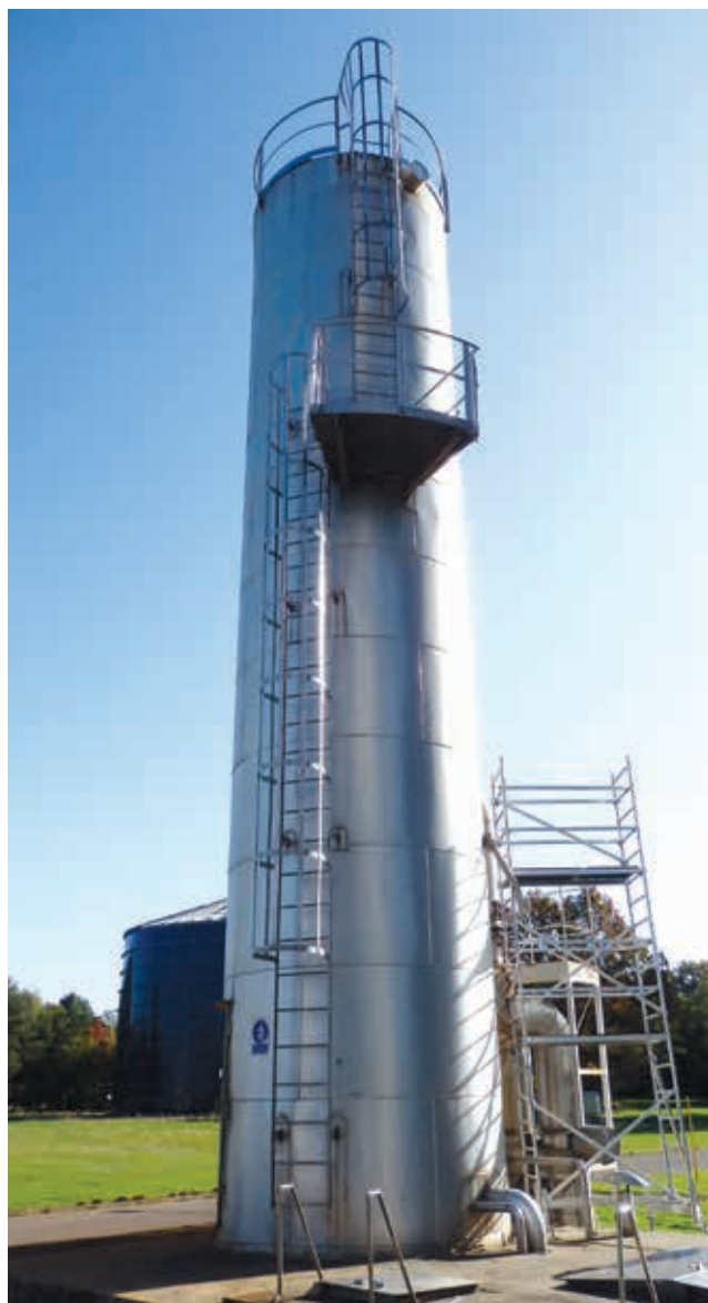
Fot. 1. Kolumna odsiarczająca 13.B wypełniona masą Sulphurex N (fot. A. Żarczyński)
