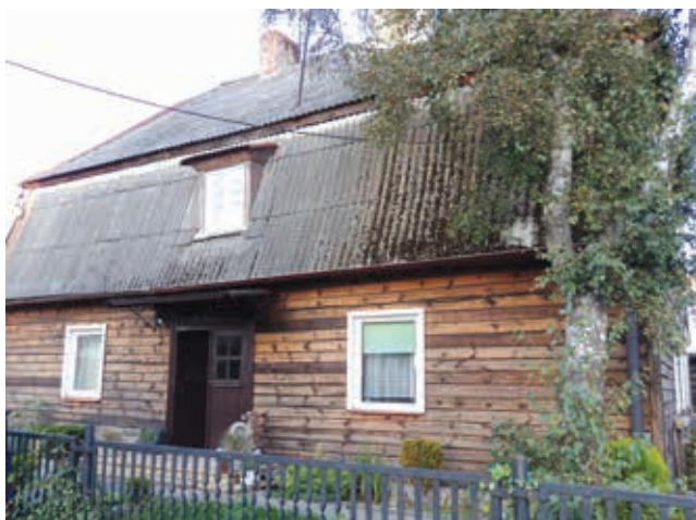
Fot. 2. Stary budynek mieszkalny pokryty eternitem.
