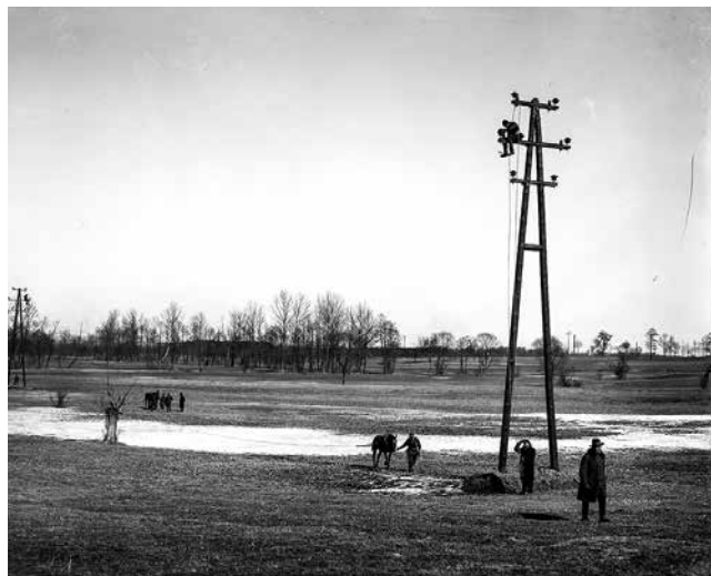
Fot. 1. Montaż linii napowietrznej do Pabianic (fot. Wiktor Jekimenko, źródło: Archiwum Veolia)
